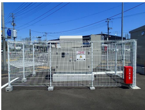
(屋外型発電機)
